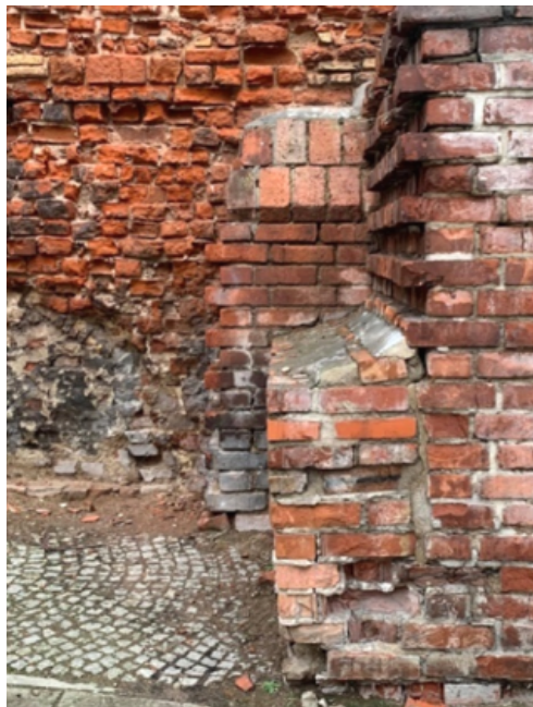
Rys. 6. Ubytki w cegle oraz stan zanieczyszczenia murów od strony ulicy Latarnianej [opracowanie własne]
