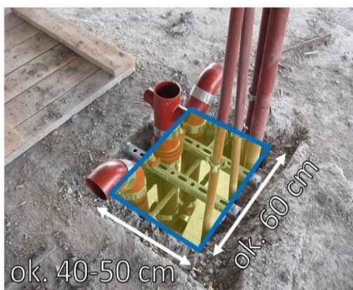
Rys. 18. Podłączenie dwóch sąsiadujących łazienek (umywalka, WC i brodzik natrysku) do jednego pionu – przykład z obiektu w trakcie budowy
