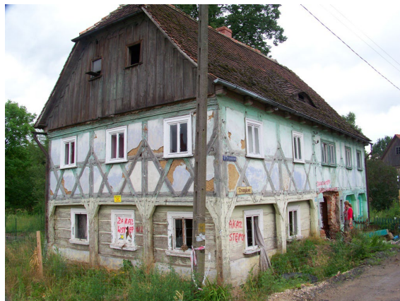
Rys. 8. Dom przy ul. Strumykowej 3 (trzecia ćw. XIX w.) o konstrukcji zasadniczo długosłupowej i długomiczowej z widocznymi fragmentami konstrukcji długosłupowej i krótkomiczowej (przy wejściu do sieni) oraz szalowaniem ścian szczytowych [fot. M. Kozaczko, 2012]
