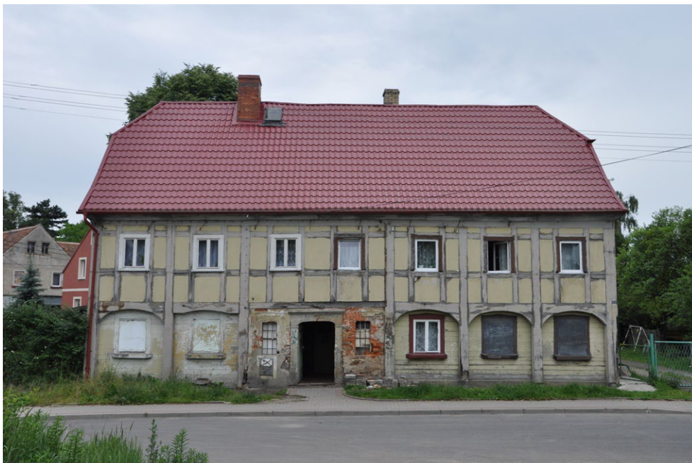
Rys. 7. Dom przy ul. Kochanowskiego 7 (koniec XIX w.) o bardzo uproszczonej konstrukcji długosłupowej z knagami, z której wyeliminowano zastrzały – ilustracja ewolucji konstrukcji długosłupowej w kierunku coraz większych uproszczeń, dokumentacja pomiarowa [8a]
