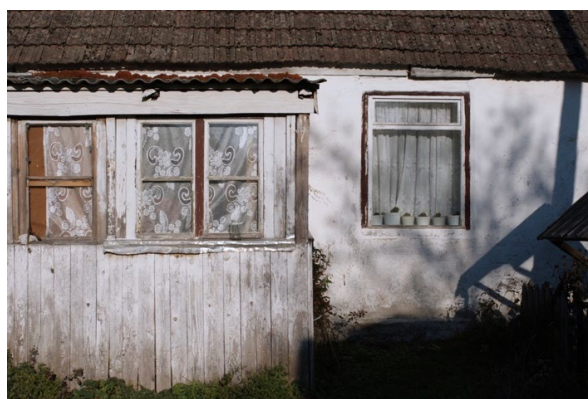
Rys. 5. Budynek szachulcowy nr 13 w Rakowie, widok od strony podwórza. Konstrukcja szachulcowa w całości pokryta tynkiem, do wejścia dobudowany drewniany ganek [fot. Angoneze Jr., 2018]
