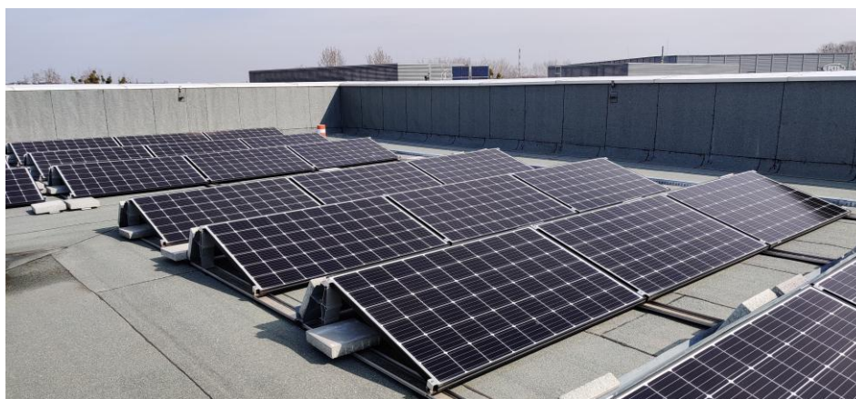
Rys. 6. Instalacja fotowoltaiczna zainstalowana na dachu budynku WAWIZ ukryta za attyką [APPSRA]
